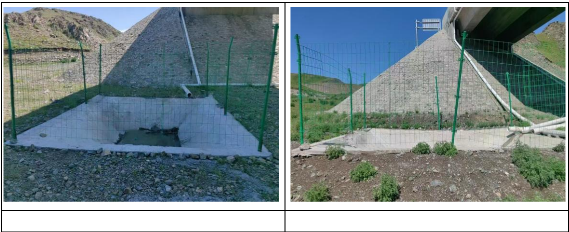
图13.2-1桥面径流收集系统及事故池照片
