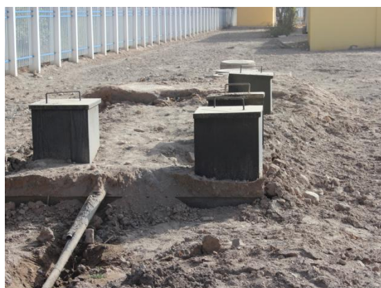
喀什收费站污水处理装置
