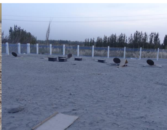
麦盖提收费站污水处理装置
