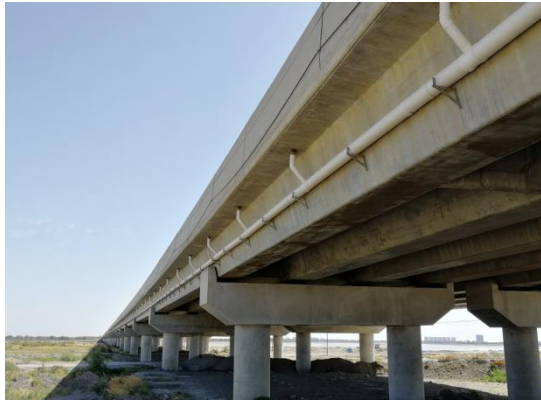
叶尔羌河特大桥桥面径流收集管道
