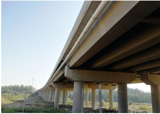
大亚郎水库大桥桥面径流收集管道
