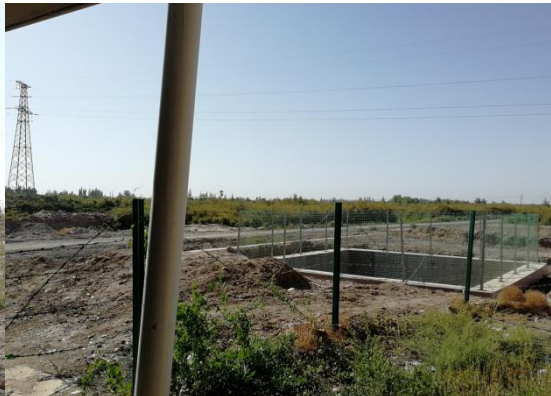
克孜勒河大桥径流收集沉淀池
