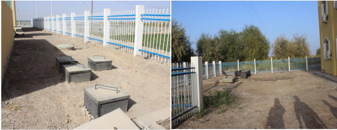
江巴孜收费站污水处理装置
