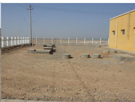
喀什服务区污水处理装置
