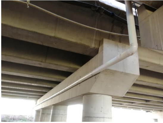
小亚郎水库大桥桥面径流收集管道
