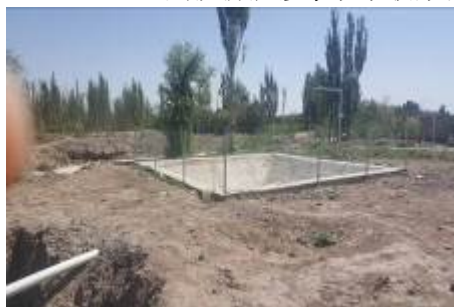
K2900+501 铁提桥防渗事故水收集池
