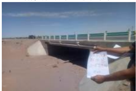
K2867+757 小桥桥面径流水收集系统
