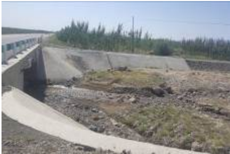
K2909+796 库都鲁克五桥桥面径流水收集系统
