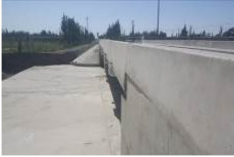
K2907+290 库都鲁克二桥桥面径流水收集系统
