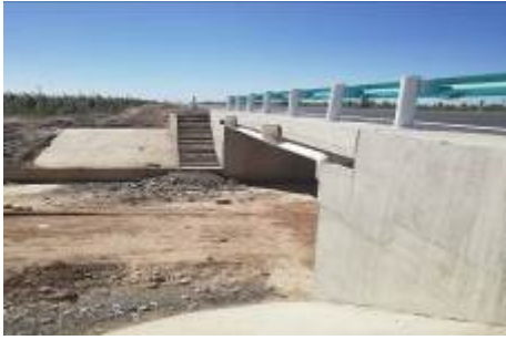
K2882+624 马牙克三桥桥面径流水收集系统
