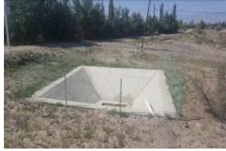
K2905+302 库都鲁克桥防渗事故水收集池
