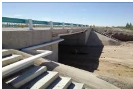
K2886+181 马牙克五桥桥面径流水收集系统
