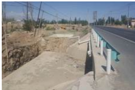
K2904+394 墨孜道班桥桥面径流水收集系统
