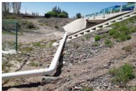
K2897+774 老黑孜桥桥面径流水收集系统
