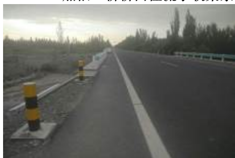
K2927+182 加依三桥桥面径流水收集系统
