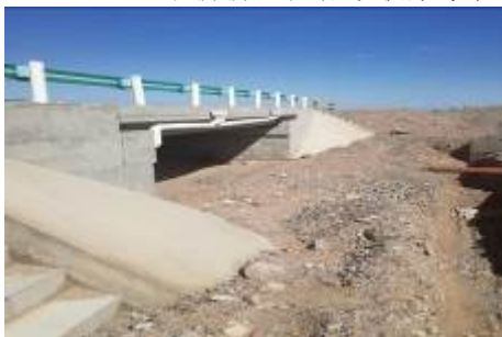
K2869+637 栏杆一桥桥面径流水收集系统
