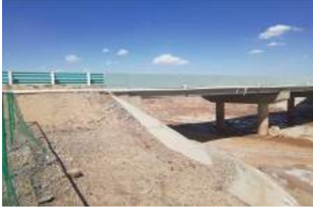
K2881+195 马牙克一桥桥面径流水收集系统
