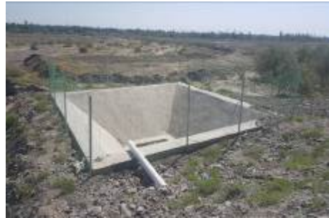
K2909+796 库都鲁克五桥防渗事故水收集池
