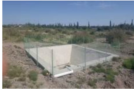
K2908+611 库都鲁克四桥防渗事故水收集池
