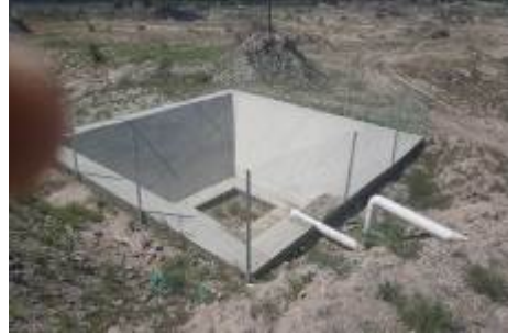
K2907+290 库都鲁克二桥防渗事故水收集池
