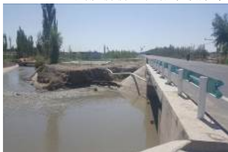
K2900+501 铁提桥桥面径流水收集系统
