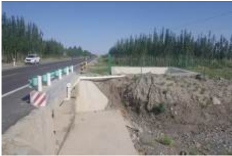
K2921+810 克力干一桥桥面径流水收集系统
