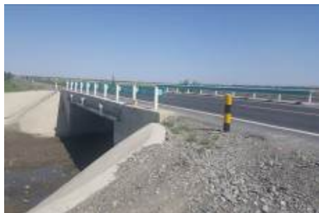
K2910+937 塔米一桥桥面径流水收集系统
