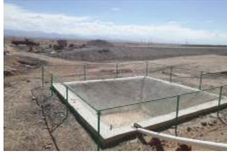
K2870+095 栏杆桥防渗事故水收集池
