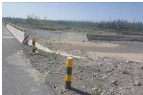
K2915+069 塔米六桥桥面径流水收集系统
