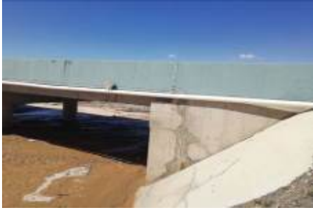
K2885+314 马牙克四桥桥面径流水收集系统
