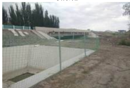
K2941+280 萨罕水库次泄洪道中桥防渗事故水收集池
