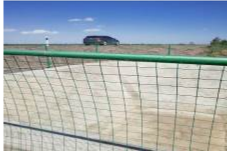
K2882+624 马牙克三桥防渗事故水收集池
