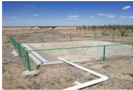
K2888+869 马牙克八桥防渗事故水收集池
