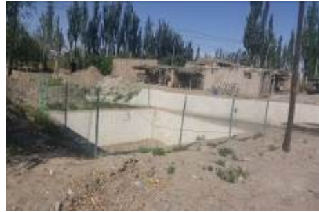
K2908+225 库都鲁克三桥防渗事故水收集池
