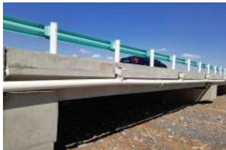
K2887+898 马牙克七桥桥面径流水收集系统
