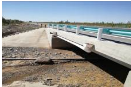
K2887+309 马牙克六桥桥面径流水收集系统
