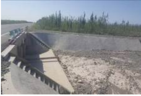
K2919+645 塔米十桥桥面径流水收集系统
