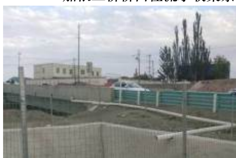
K2941+028 萨罕水库主泄洪道中桥桥面径流水收集系统
