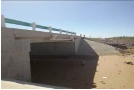
K2881+754 马牙克二桥桥面径流水收集系统
