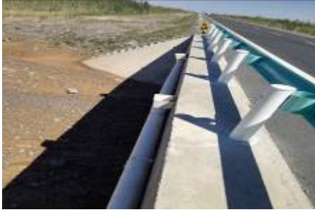
K2891+969 马牙克十一桥桥面径流水收集系统
