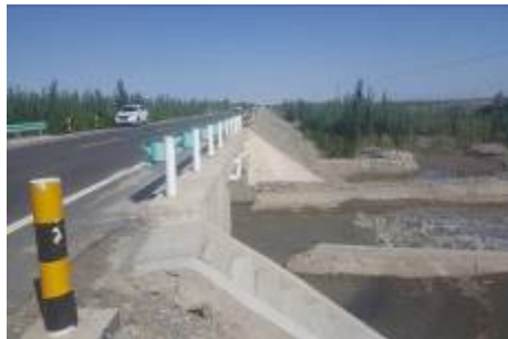
K2917+027 塔米八桥桥面径流水收集系统
