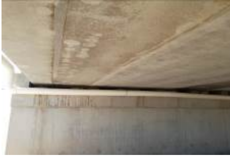
K2891+501 马牙克十桥桥面径流水收集系统
