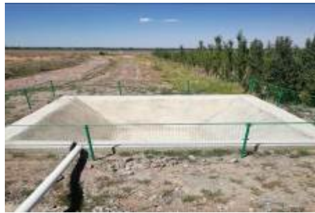
K2897+291 马牙克十四桥防渗事故水收集池
