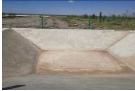
K2893+065 马牙克十二桥防渗事故水收集池
