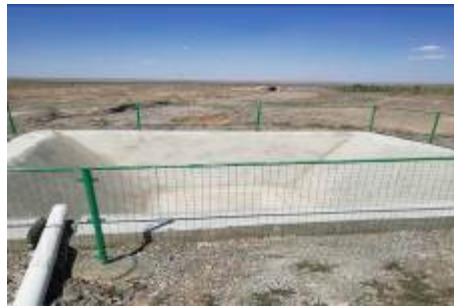
K2890+879 马牙克九桥防渗事故水收集池
