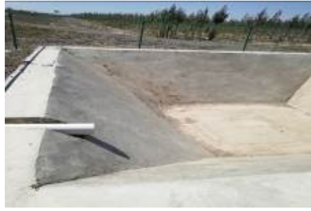
K2891+501 马牙克十桥防渗事故水收集池
