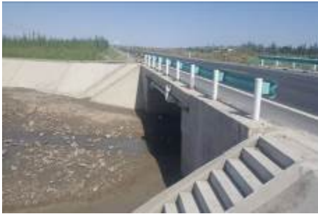
K2908+611 库都鲁克四桥桥面径流水收集系统
