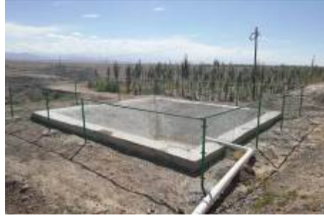
K2881+195 马牙克一桥防渗事故水收集池
