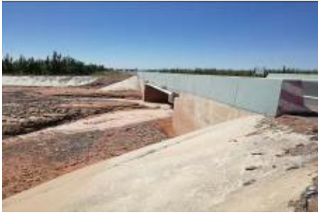
K2896+481 马牙克十三桥桥面径流水收集系统
