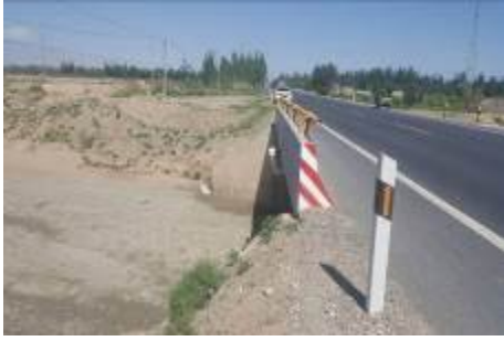
K2905+302 库都鲁克桥桥面径流水收集系统
