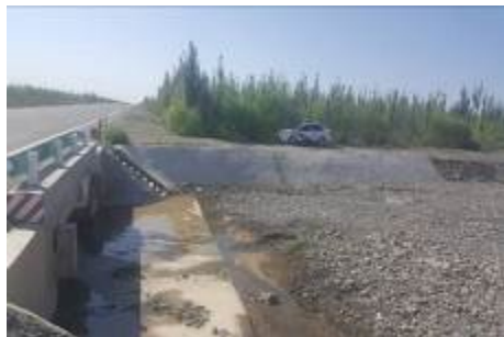
K2919+043 塔米九桥桥面径流水收集系统
