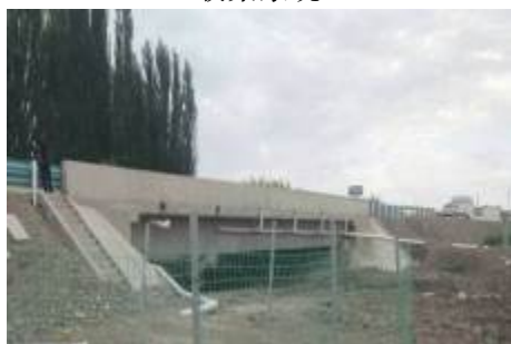
K2941+280 萨罕水库次泄洪道中桥桥面径流水收集系统
