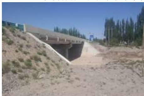
K2902+847 乔木伦桥桥面径流水收集系统
