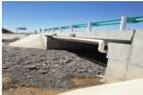
K2890+879 马牙克九桥桥面径流水收集系统
