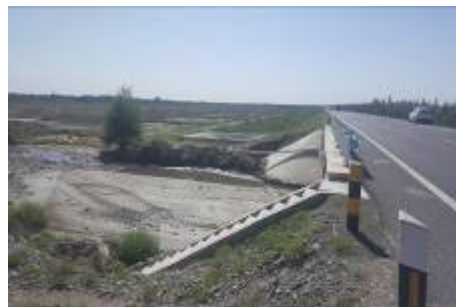
K2910+937 塔米一桥防渗事故水收集池
