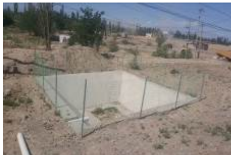
K2904+394 墨孜道班桥防渗事故水收集池
