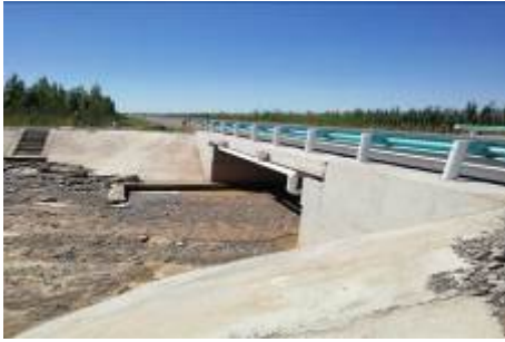
K2893+065 马牙克十二桥桥面径流水收集系统
