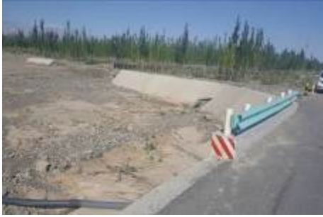
K2921+181 塔米十一桥桥面径流水收集系统
