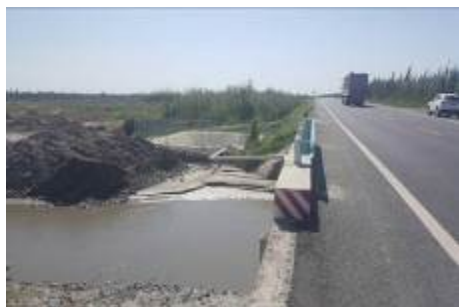
K2910+402 库都鲁克六桥桥面径流水收集系统
