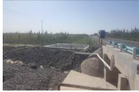
K2919+645 塔米十桥防渗事故水收集池
