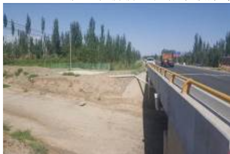
K2904+837 墨孜道班桥二桥桥面径流水收集系统
