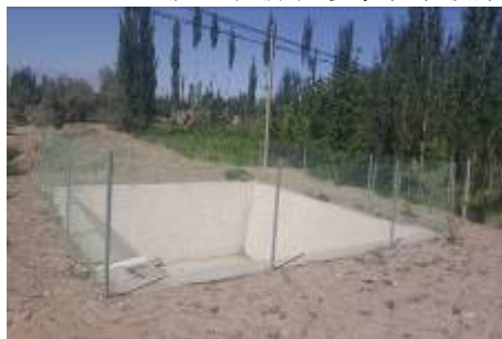
K2904+837 墨孜道班桥二桥防渗事故水收集池
