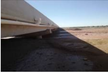
K2870+095 栏杆桥桥面径流水收集系统
