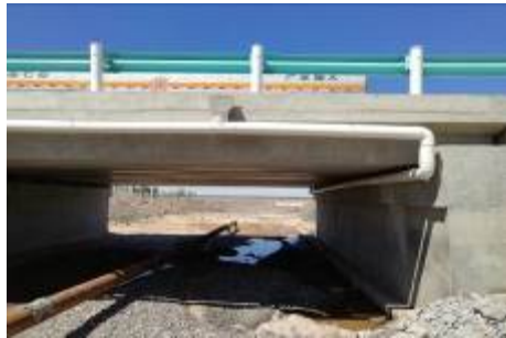
K2888+869 马牙克八桥桥面径流水收集系统
