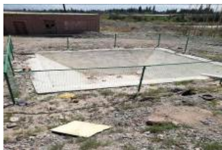
K2897+774 老黑孜桥防渗事故水收集池
