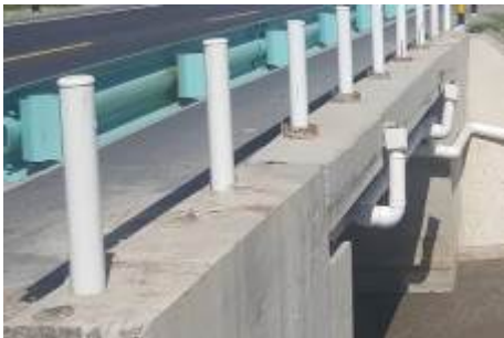
K2924+111 加依一桥桥面径流水收集系统
