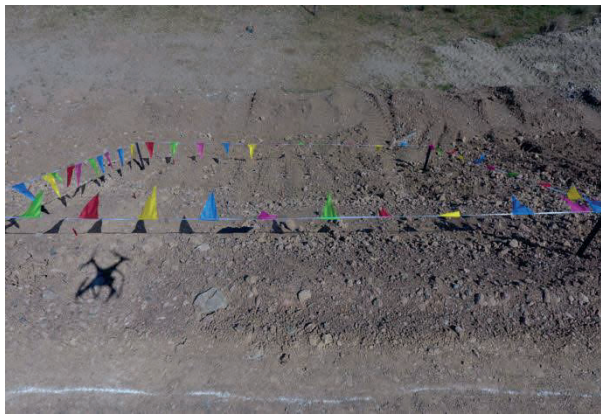
图1.3-10 路基边坡监测点
