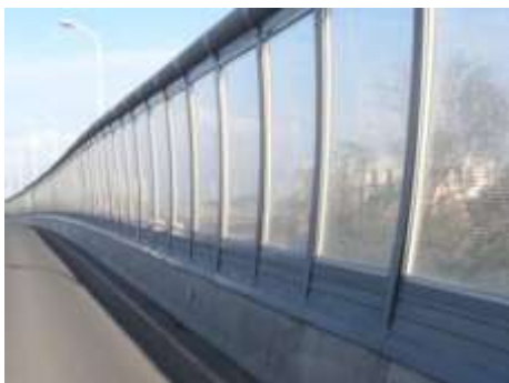
跨水磨河桥梁防撞护栏及防抛屏障
