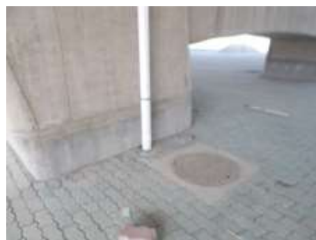
高架桥下径流进入市政管网
