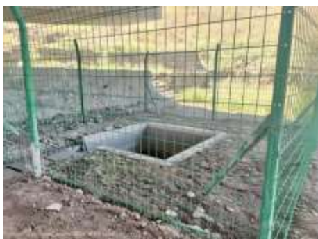
高架桥下收集收集池
