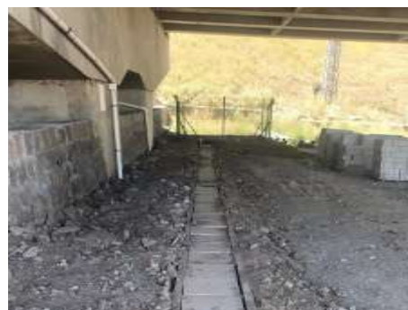
高架桥下收集收集池
