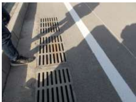
路基段排水边沟
