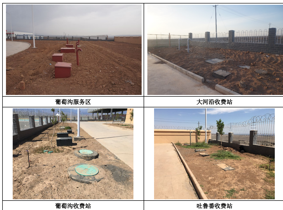
图 8.3-1 沿线设施污水处理设施情况
