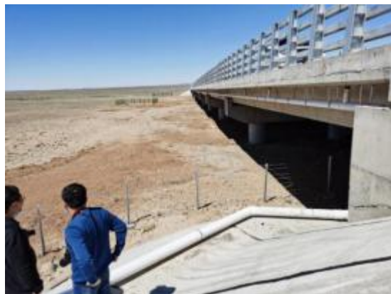
桥面径流收集系统
