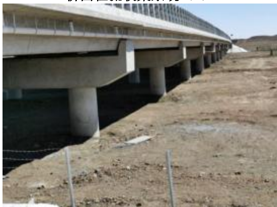
桥面径流收集系统 (2)
