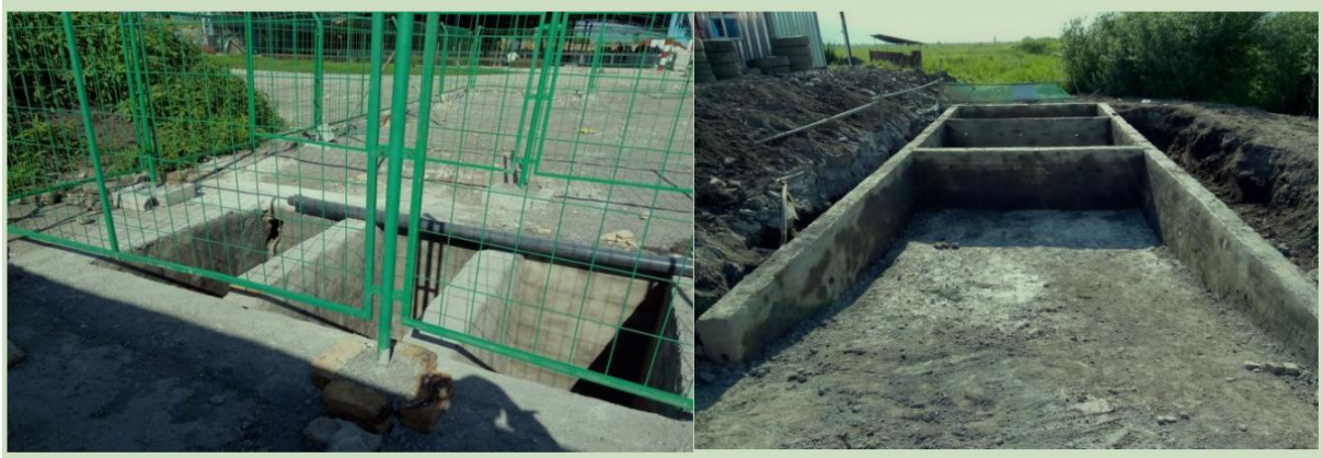
图 8.2-1 施工废水三级沉淀池
