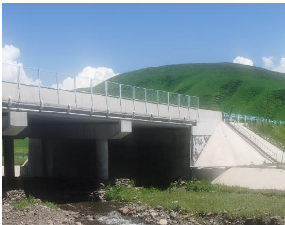
桥面径流收集系统
