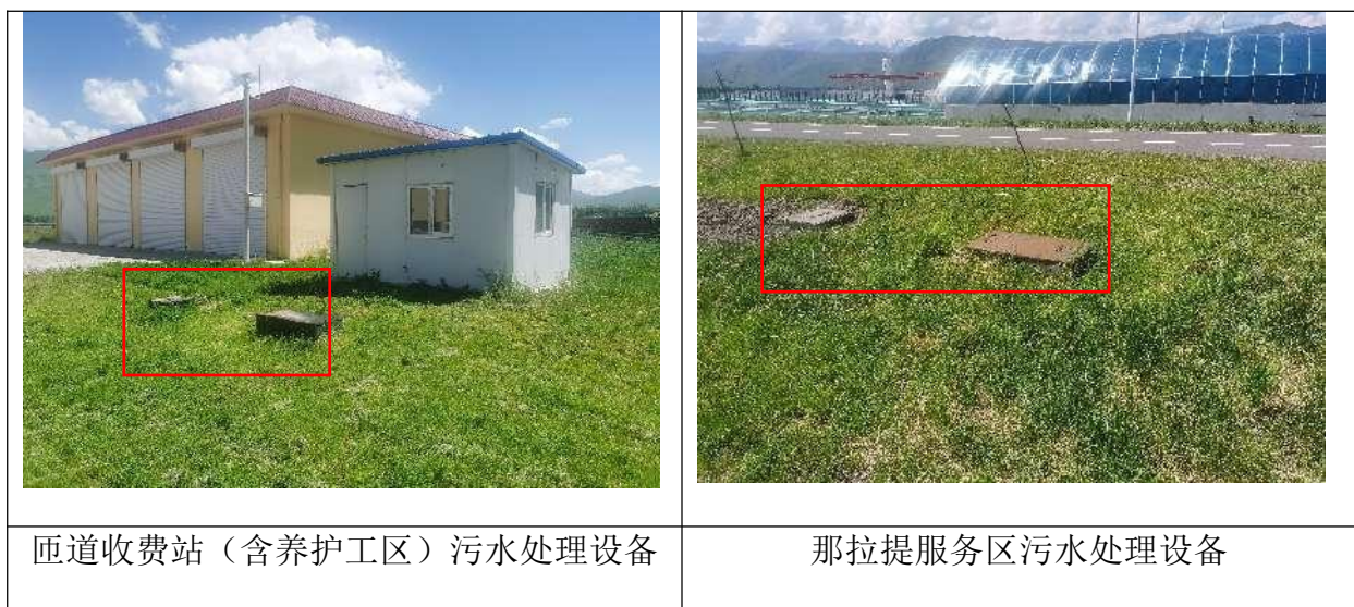
图 8.3-1 沿线服务设施一体化污水处理设施
