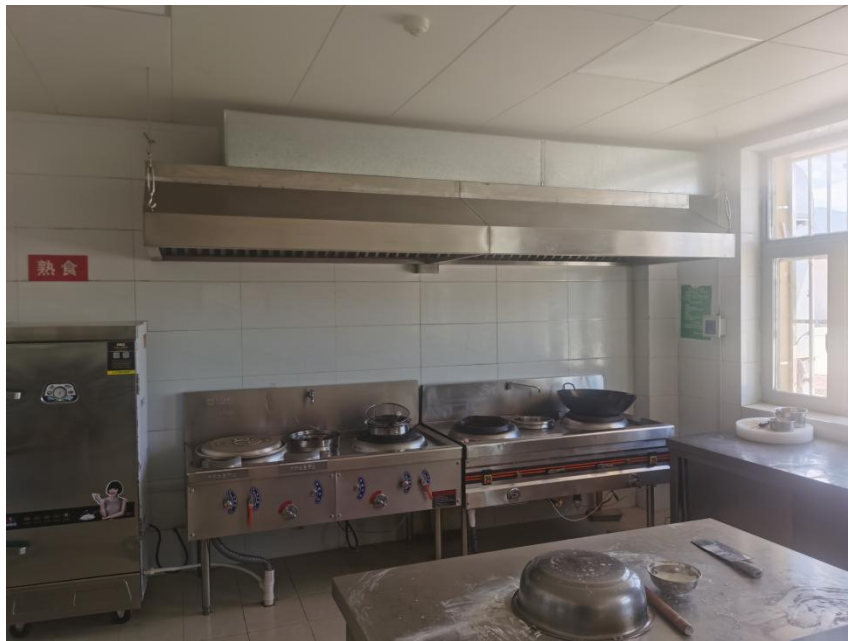
图 7.3-1 匝道收费站（含养护工区）食堂油烟净化装置
