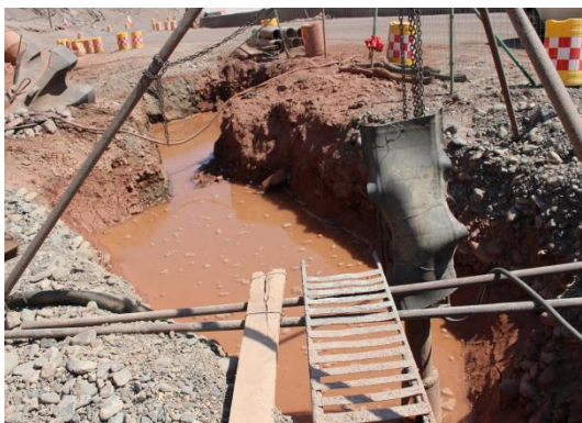
图 4.3-11 桥梁工程沉淀池
