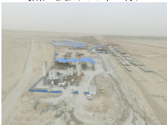
2 标梁场及拌合站 (2015 年 11 月)
