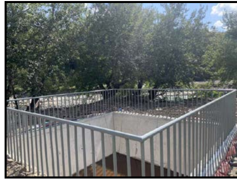
K84+275 喀什河大桥事故应急池护栏
