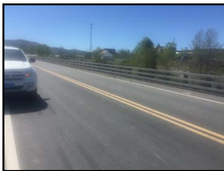
桥面封闭收集系统
