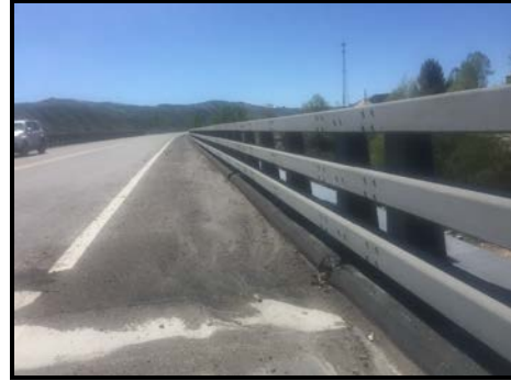
桥梁防撞护栏
