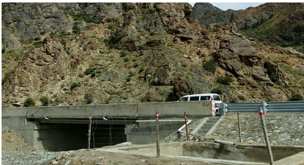
图 6.1-3 焕彩沟 2#小桥桥面径流收集系统和收集池
