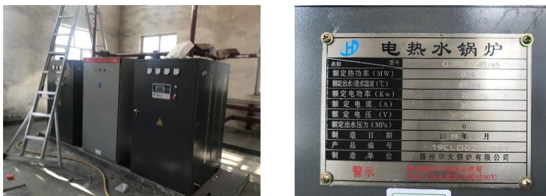
图 8.2-1 松树塘养护站电锅炉
